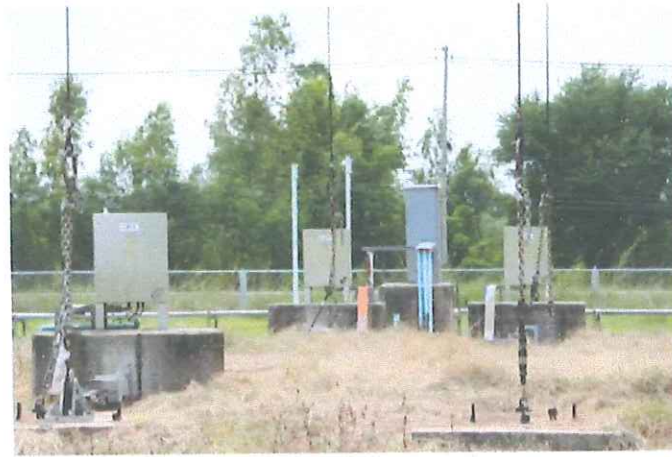
รูปภาพที่ 5 อุปกรณ์ไฮโดลิกผ่อนการต้านแรงลม สำหรับสายอากาศตราอักษร Macroni จำนวน 12 ชุด พร้อมอุปกรณ์ส่วนควบ และตู้ไฟฟ้า พร้อมฐานคอนกรีต จำนวน 14 ตู้
